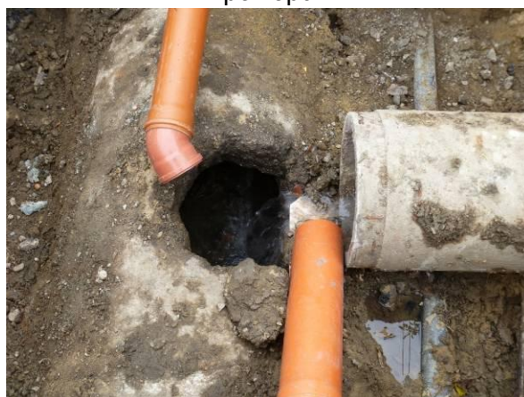
Stoka BD – stávající inženýrské sítě v místě napojení budoucí šachty B9
